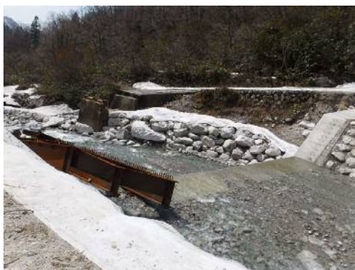
（橋が落ちているので渡渉）
